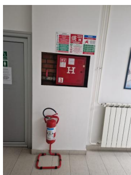
Fire equipment 1.jpg
