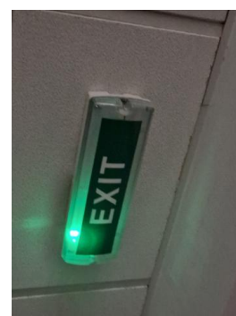
Evacuation sign 1.jpg
